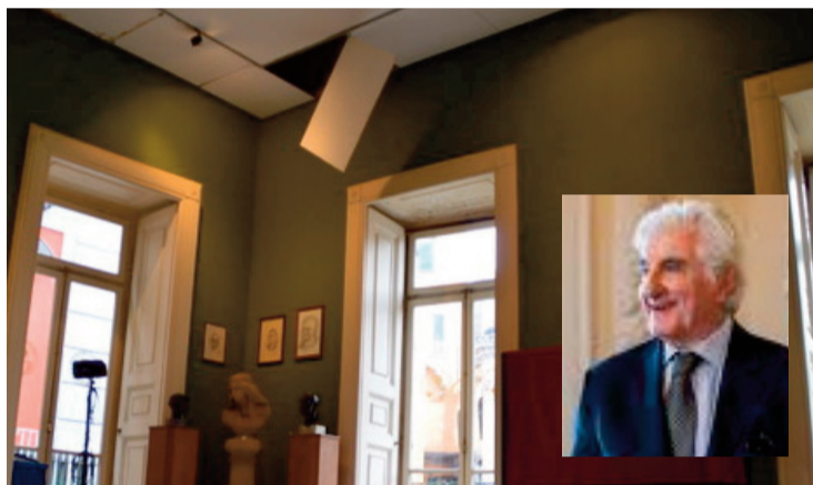
Controsoffittatura pericolante nella sala museale Sirignano. Nel riquadro Adriano Gaito
