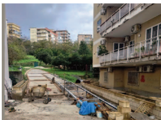
● L'ingresso dell'ex Gasometro, lavori fermi perché manca materiale
